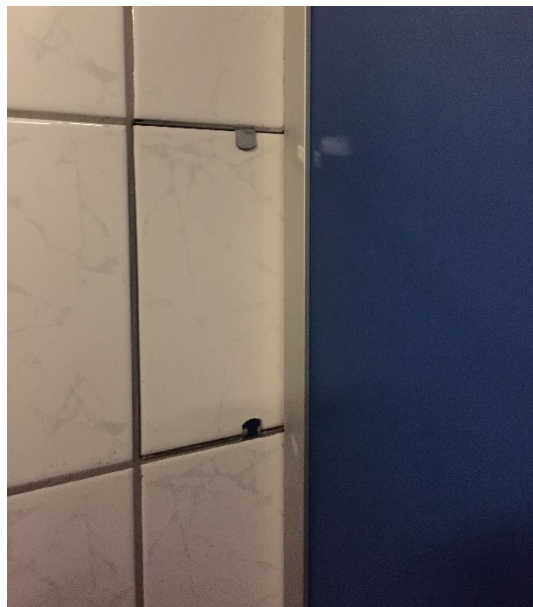
Abb. 9 Unerreichbare Revisionsklappe, 2017, Riesa
