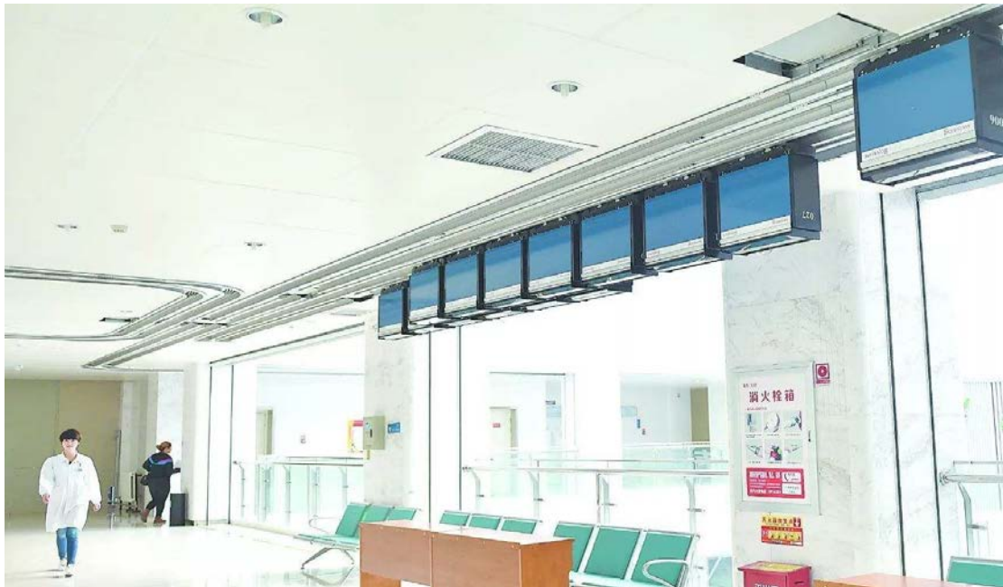
Abbildung 2: Schienen- und Fördersysteme im Krankenhaus 3
