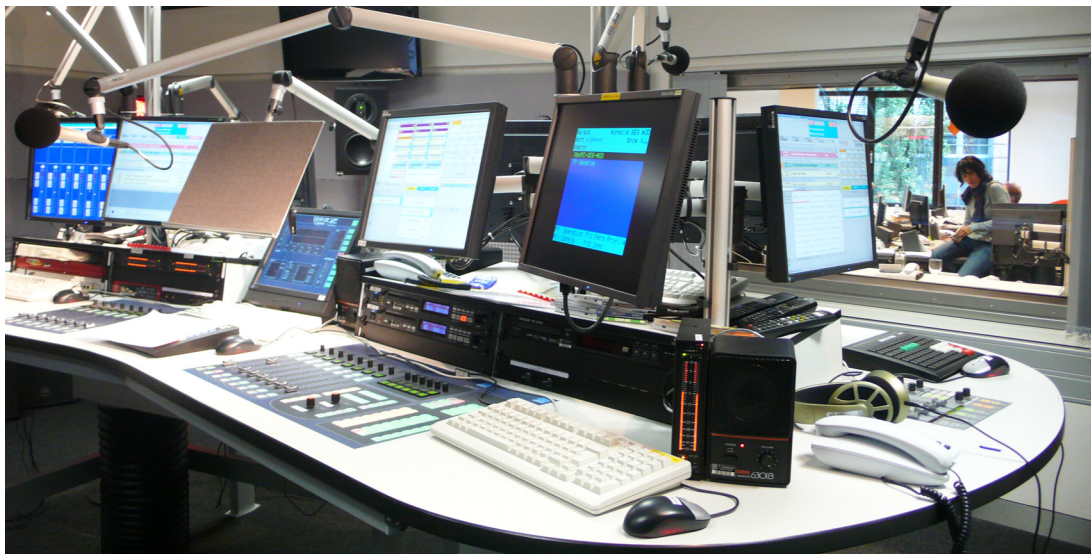
Abbildung 5: Blick aus dem SES durch eine Glasscheibe in den Hotroom
