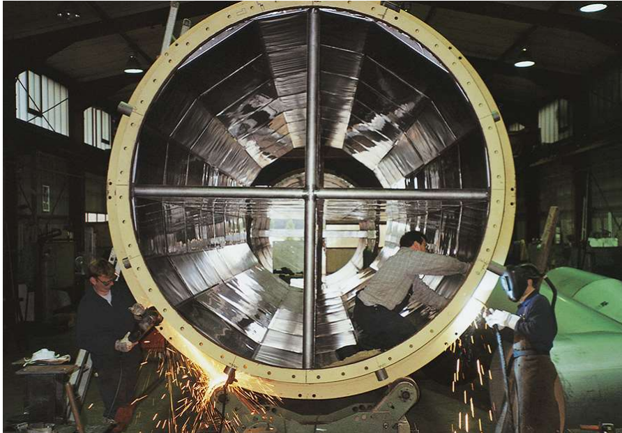
Abbildung 12 Schalldämpfender Schornstein in der Fertigung (Quelle: Niessing Anlagenbau)
