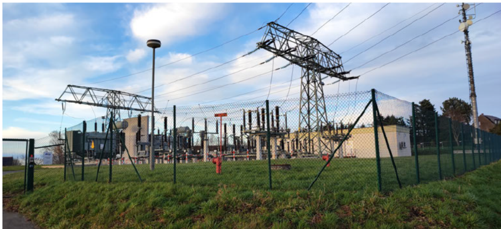
Abbildung 5.3: 110 kV Umspannwerk Leisnig [eigene Aufnahme]
