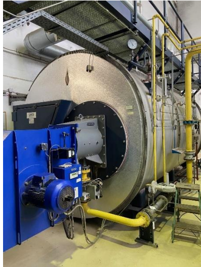
Abbildung 44: Dampfkessel zur Dampferzeugung im Kesselhaus
