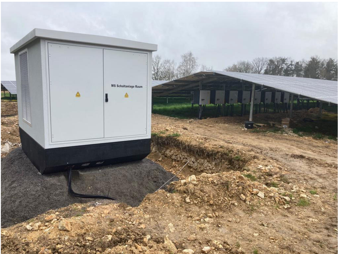
Abbildung 37: Aufbau einer Ost-West- Anlage mit Trafostation (Bildauszug aus einem anderen Projekt)
