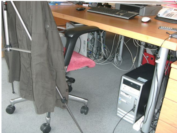
Die Kabel und Rechner im Fußbereich
