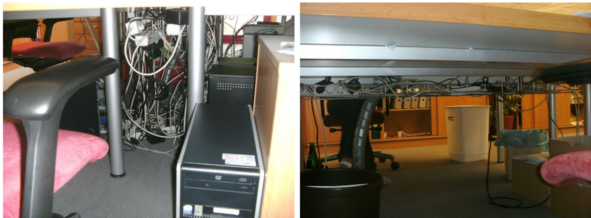
Abb. 2-2: Bilder von Kabeln und PC im Fußbereich, Kabelführungen unter dem Schreibtisch
