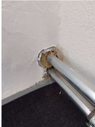
Abbildung 24: Heizungsrohre führen durch eine Öffnung in der Wand. (Quelle: Eigene Aufnahmen)
