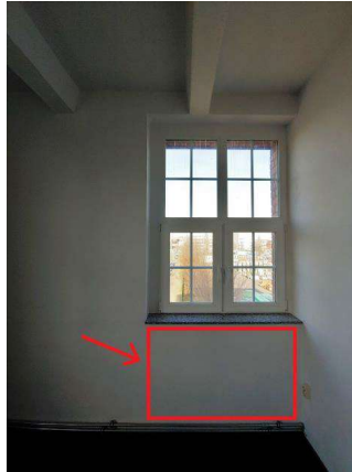
Abbildung 33: Hohlraum unterhalb des nördlichen Fensters (Quelle: Eigene Darstellung)
